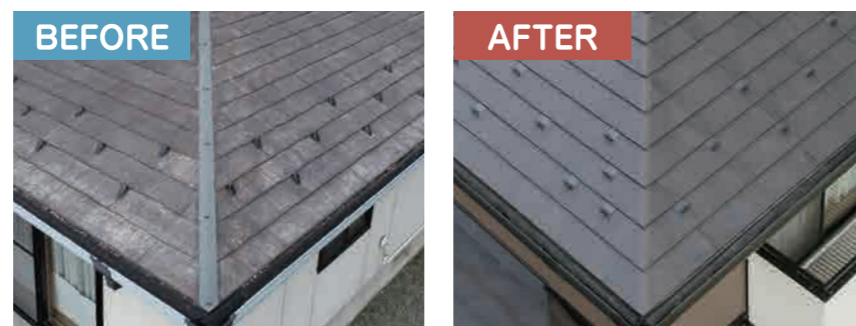
劣化した化粧スレート
