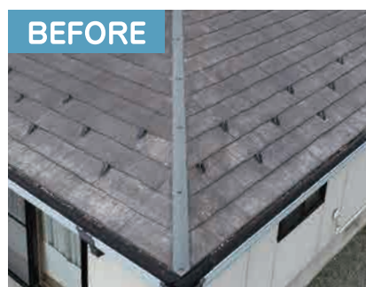
劣化した化粧スレート
