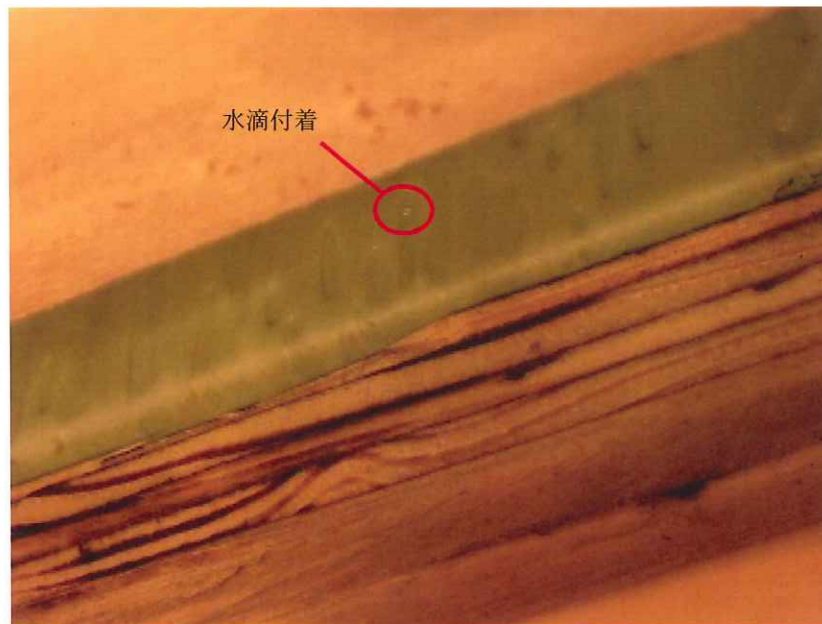
写真-5 漏水状況（赤枠内拡大）
